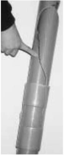
ウォーター ハンマーを 起こした管
