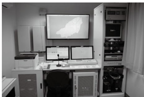
▲防災行政無線室内
