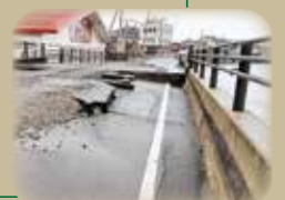
能登半島地震 道路崩壊
