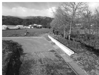
大雨の際十分に機能しない水兼道路排水口
