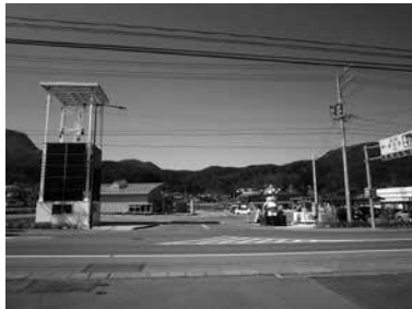
緊急時の電源施設
